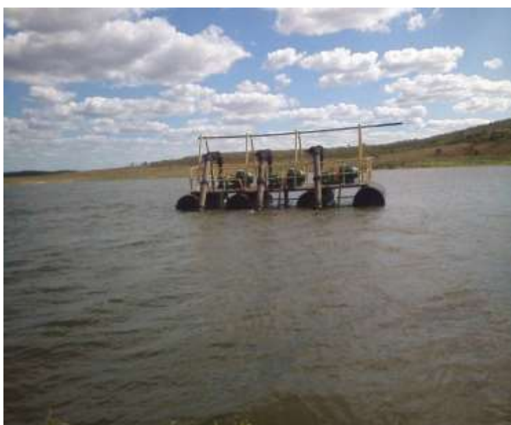
Figura 4 - Sistema de captação - Açude General Sampaio
