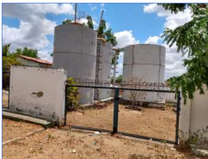
Figura 9 - Sistema de tratamento de efluentes - Bairro Palestina/Sangradouro
